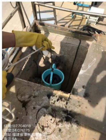
废水处理站进口
